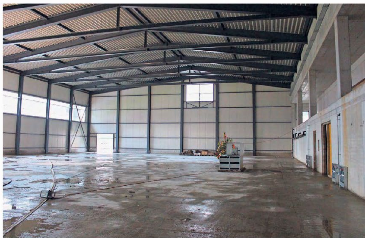
Die Halle ist mit ihrer Höhe sowohl für Floorball- als auch Handball-Wettkämpfe geeignet. Rechts werden noch zwei Tribünenteile angebaut.
